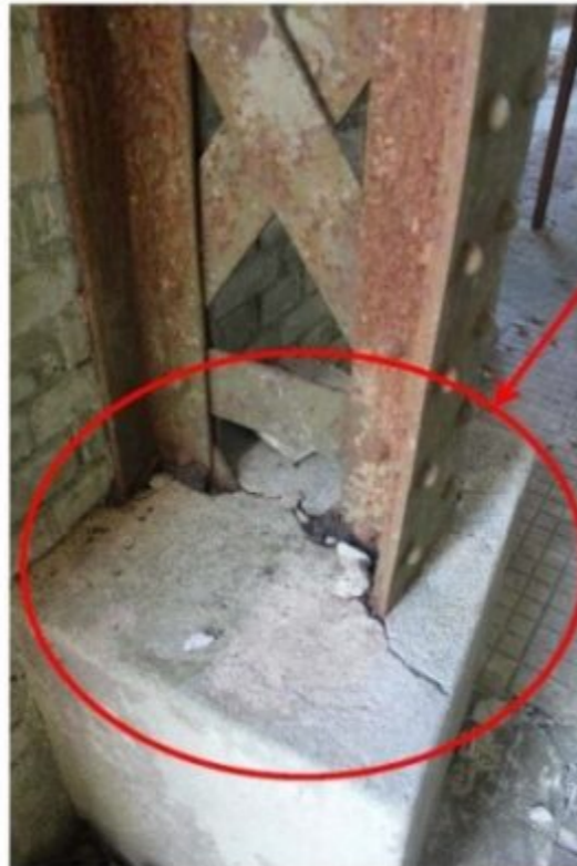
Diversos grados de Patología en los arranques de pilares
