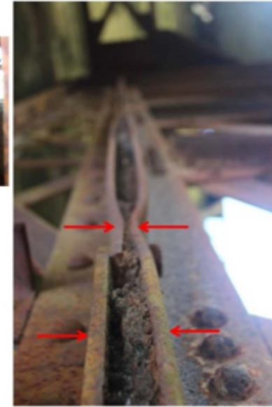
Los remaches soportan la tracción de la corrosión
