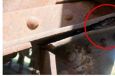
Detección de patologías en las uniones
